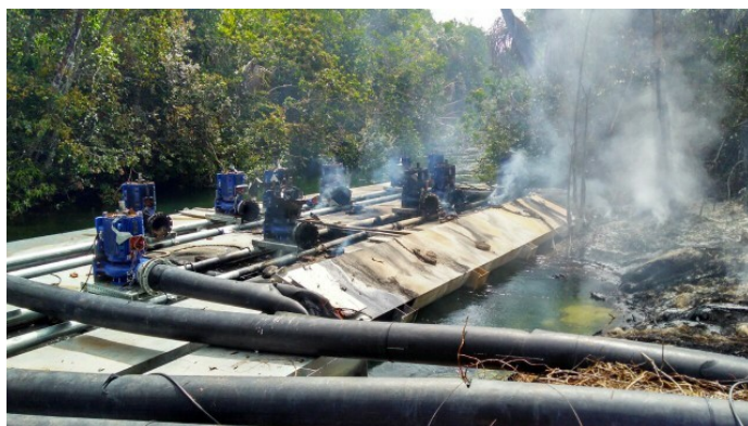
Figura 1 - Bombas de captação no Rio Arrojado destruídas.
